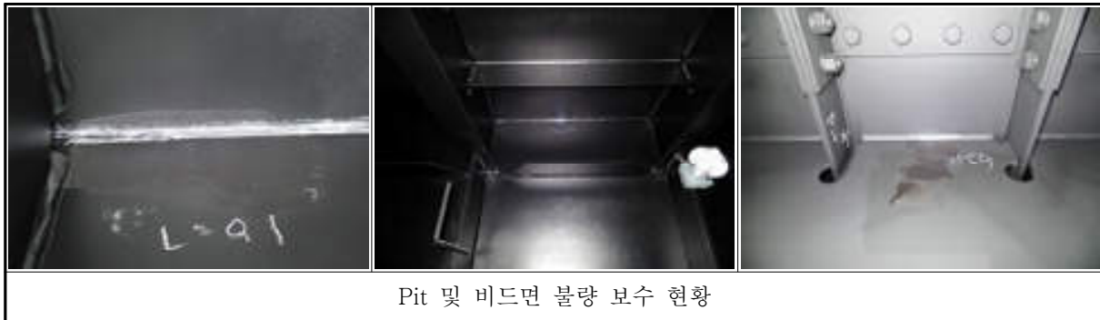
【표 3-43】 양평방향 - Steel Box Girder 내부 기 진단결과 비교
